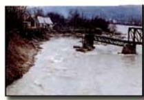
Зруйнований у повінь 4-8 березня 2001 р. залізничний міст на р. Тересва
